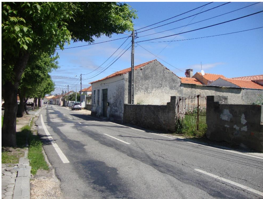
Figura 100. Pavimento da Rua Direita com mau estado de conservação com fissuras visíveis
