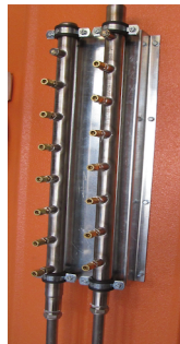
Figura 66 – Coletores de recirculação de água para o arrefecimento das sondas de amostragem (cortesia Ventil – Engenharia do Ambiente, Lda.).
