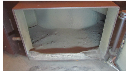
Figura 69 – Zona de inversão de gases do permutador (cortesia Ventil – Engenharia do Ambiente, Lda.).
