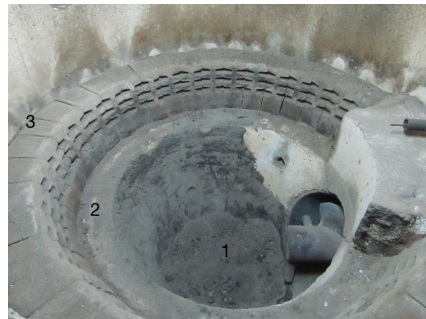
Figura 70 – Zona de combustão de biomassa; 1 – Cadinho da fornalha; 2 – zona de introdução de ar primário; 3 – Ponto de amostragem sobre as grelhas de combustão.
