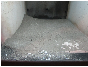
Figura 68 – Zona junto à porta caldeira (cortesia Ventil – Engenharia do Ambiente, Lda.).
