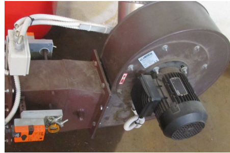
b) Toma de medição à saída do ventilador de combustão de ar.
