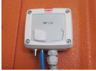
Figura 32 – Sensor de pressão CP110 da Kimo instruments instalado num ponto fixo da caldeira para medição em contínuo da depressão (cortesia Ventil – Engenharia do Ambiente, Lda.).
