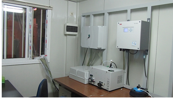
Figura 40 – Sistema de monitorização de gases de combustão. Analisador de gases ABB no canto superior direito. Condicionador de gases em baixo do lado direito (cortesia Ventil – Engenharia do Ambiente, Lda.).
