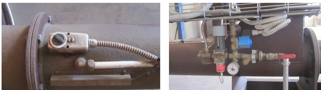
Figura 19 - Sistema de detecção e extinção de incêndio. Sistema elétrico (esquerda). Sistema mecânico (direita) (Cortesia Ventil – Engenharia do Ambiente, Lda.).
