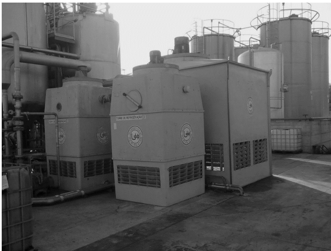
Figura 11: Torres de refrigeração para arrefecimento de água da unidade de regeneração de solventes da EGEO Solventes S.A.
