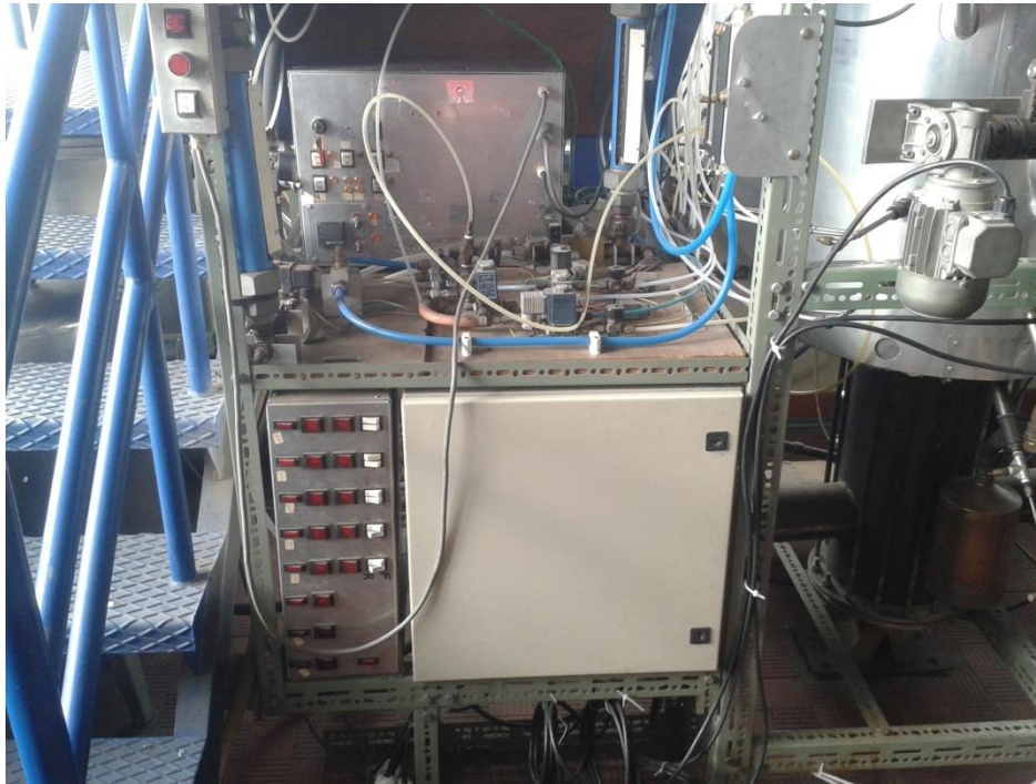
Figura 4.3 – Unidade de Comando e Controlo 2 (UCC2).
