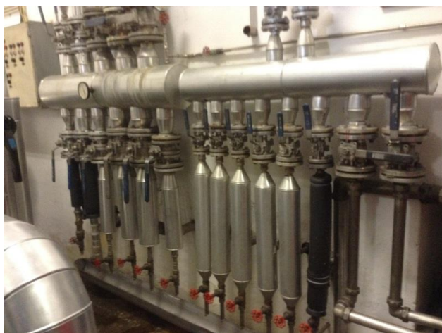
FIGURA 13 - COLETOR DE ENVIO DA ÁGUA (À ESQUERDA) E COLETOR DE RETORNO DA ÁGUA (À DIREITA).
