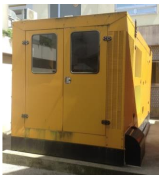
FIGURA 41 - GERADOR DE 800 KVA
