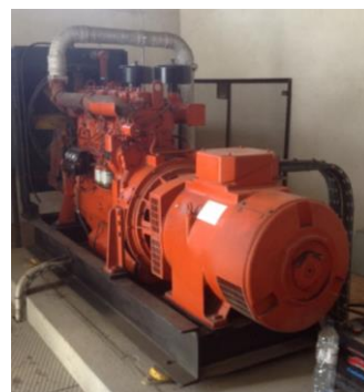
FIGURA 43 - GERADOR DE 100 KVA
