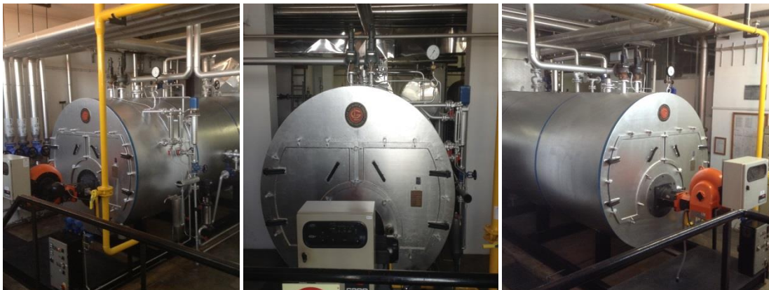
FIGURA 35 – GERADORES DE VAPOR A GÁS NATURAL NA CENTRAL TÉRMICA – UNIDADE AVEIRO.
