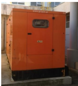
FIGURA 42 - GERADOR DE 400 KVA
