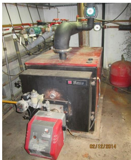
FIGURA 46 – CALDEIRA NTD 130 - AVAC
