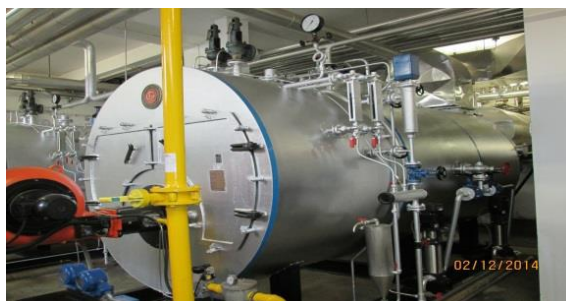
FIGURA 44 - GERADOR DE VAPOR
