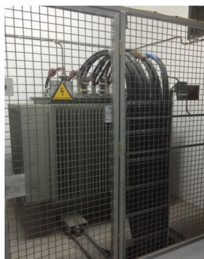
FIGURA 39 - TRANSFORMADOR N.º 2 - AVEIRO
