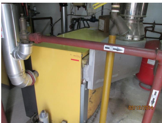
FIGURA 47 – CALDEIRAS DE APOIO AO AVAC
