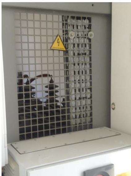
FIGURA 40 - POSTO DE TRANSFORMAÇÃO - ÁGUEDA.
