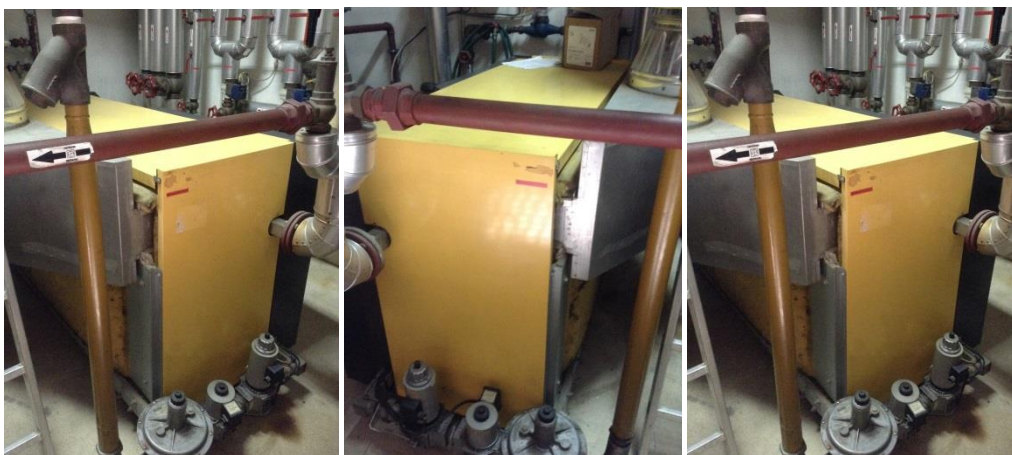
FIGURA 36 - CALDEIRAS A GÁS NATURAL NA CENTRAL TÉRMICA – UNIDADE ÁGUEDA
