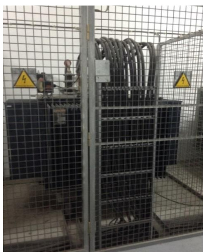
FIGURA 38 - TRANSFORMADOR N.º 1 - AVEIRO
