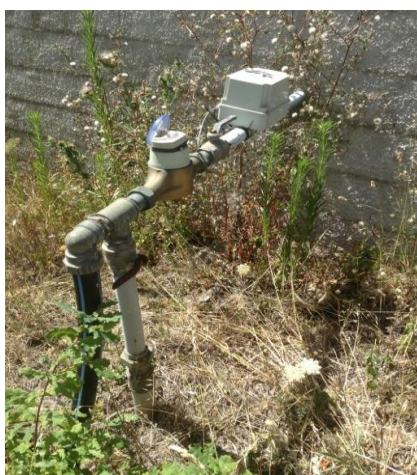
FIGURA 21 - PONTO DE ENTRADA DE ÁGUA DO EDIFÍCIO PRINCIPAL DO HOSPITAL.
