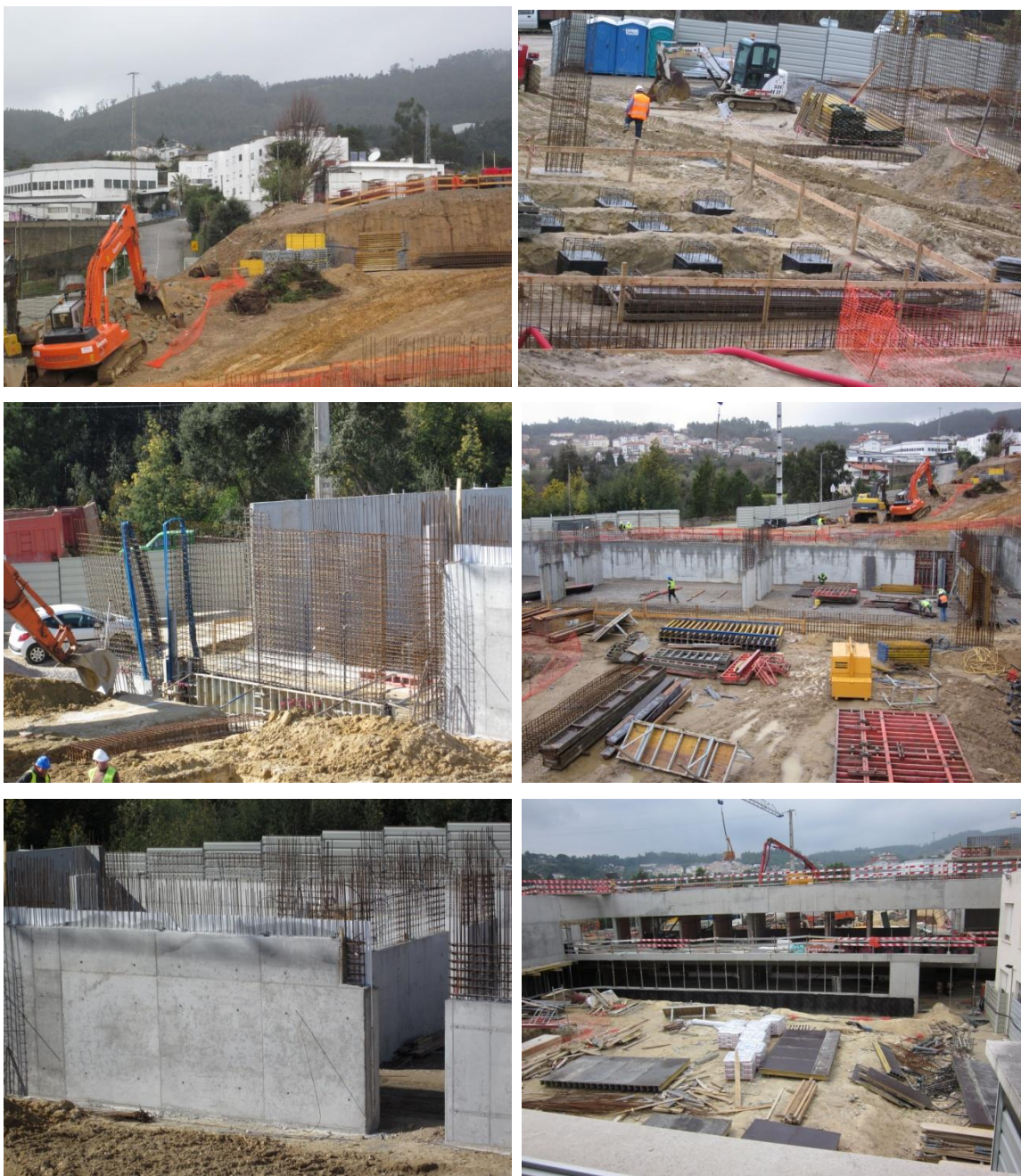
[1] Fotografias das etapas de construção dos edifícios escolares, captadas durante a implementação do projeto, desde as fundações até à edificação da estrutura.
