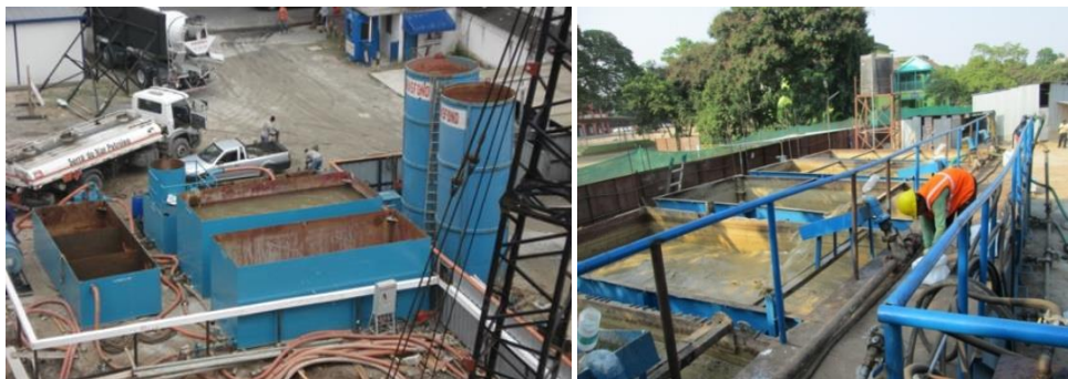
[2] Tanque de armazenamento (fonte: GEO [2:8]).
