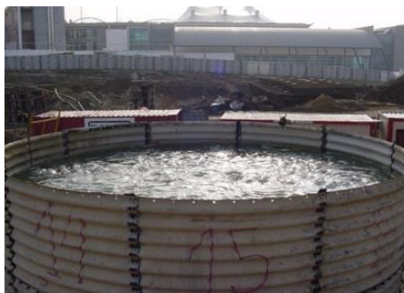
[1] Tanque de armazenamento (fonte: GEO [2:8]).
