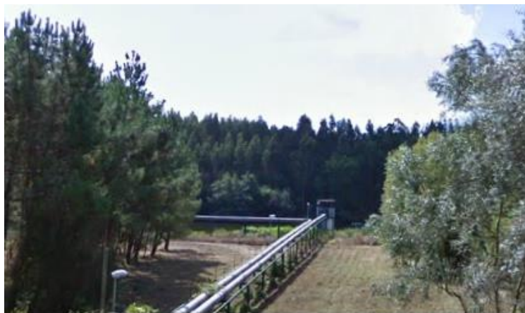
Figura 1.7 – Um dos poços de captação e sistema de transporte à ETA do Carvoeiro.
