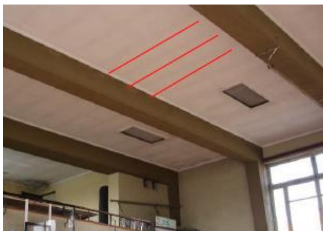
Figura 23 – Marcas das vigotas na laje do teto do ginásio (FEUP, 2007).
