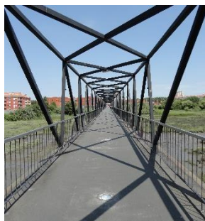
Figura 6.4 - Vista da distribuição dos focos luminosos ao longo da ponte pedonal.
