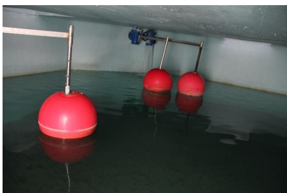
Figura 5.7 - Ilustração do interior do reservatório, denotando-se o sistema de boias para controlo do nível de água do reservatório.
