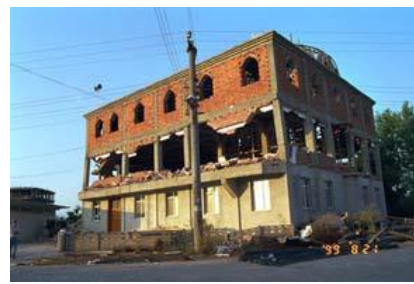
Figura A.5 - Exemplo de uma estrutura com danos devido a irregularidades (H. F. P. Rodrigues, 2005).
