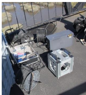
Figura 6.16 - Placa de aquisição de dados, cabos extensómetros e UPS utilizados.
