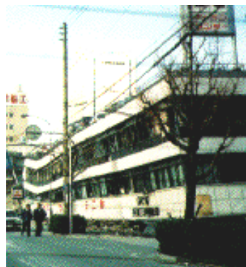
Figura A.7 - Exemplo de um mecanismo de soft-storey devido a pisos vazados (Varum, 2003).
