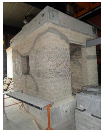
Figura 3.14 - Aspeto geral da estrutura após a retirada do reboco, realização da nova selagem das fissuras e colocação da rede de reforço.
