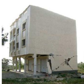
Figura A.4 - Ilustração de danos ocorridos numa estrutura devido ao recuo (Estêvão, 2012).
