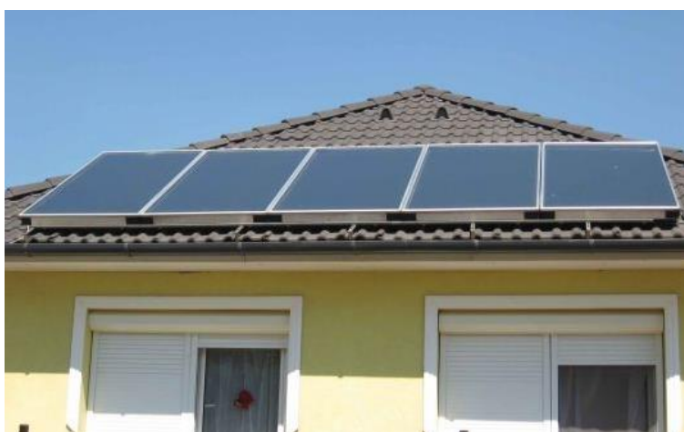
Figura 2.22 – Painel solar de aquecimento de água de uma habitação [36]
