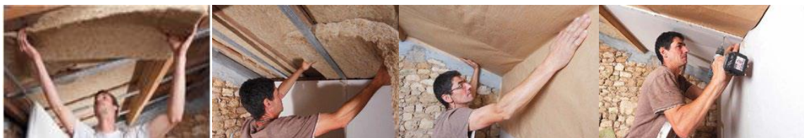
Figura 4.2 – Sistema construtivo de isolamento térmico em cobertura inclinada (Biofib Duo e Métisse)
