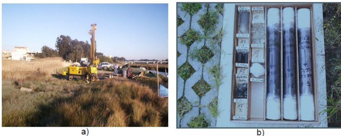
Figura 4.2- Amostragem indeformada no local SA2 (Agra-Esgueira); (a) máquina de sondagem; (b) amostras recolhidas (Bonito 2008).
