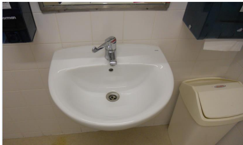
Figura 30 - Torneira do lavatório (Instalação sanitária - deficientes)
