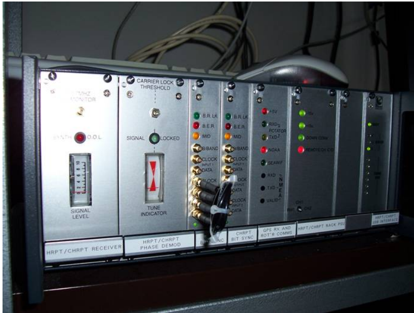
Figura 6.4: Visão da rack de recepção da Estação HRPT da UA.
