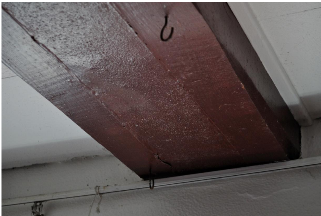
Ilustração 50 – Reforço de betão envolvido por duas vigas de madeira no local da parede removida (local A – Ilustração 48)
