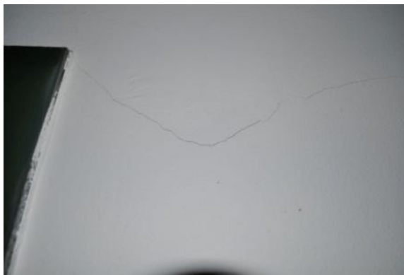
Ilustração 82 - Fissuração ao nível da padieira no compartimento C3_0
