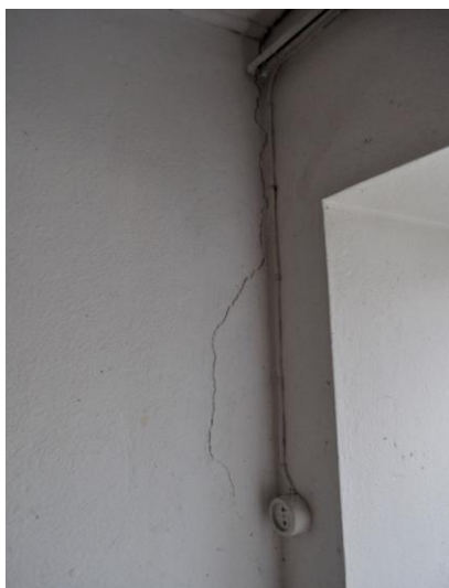
Ilustração 84 – Fissuração da parede que separa os compartimentos C8_0 e C9_0
