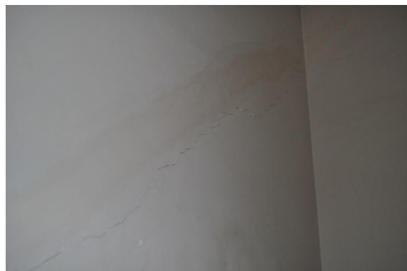
Ilustração 86 - Fissura diagonal característica do piso 1 – C2_1
