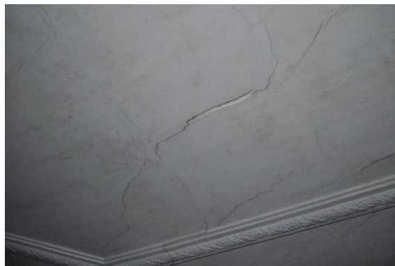
Ilustração 88 - Fissuração generalizada do teto do compartimento C1_2
