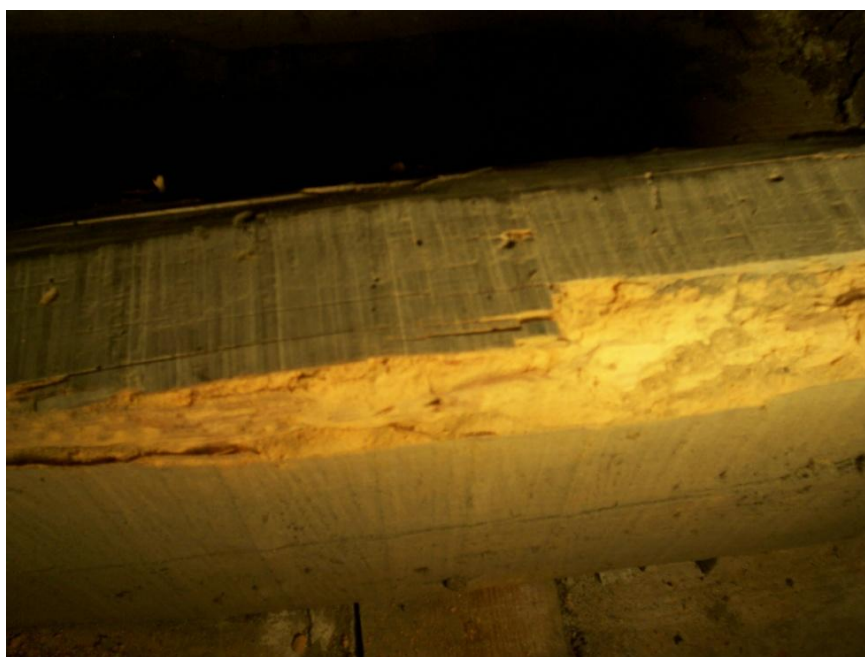
Ilustração 90 – Ataques de insetos ocorridos numa viga da cobertura
