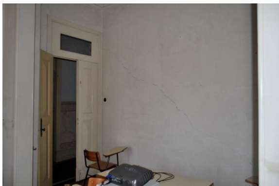
Ilustração 85 – Fissura diagonal característica do piso 1 – C1_1
