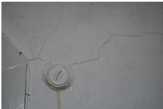
Ilustração 87 - Fissuração ao nível da padieira no compartimento C1_2
