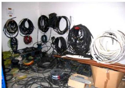
Figura 36. Secção de cabos elétricos desorganizada.
