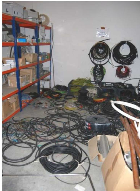
Figura 25. Cabos elétricos mantidos no chão na zona de acesso às estantes de material elétrico e aos cabos elétricos.
