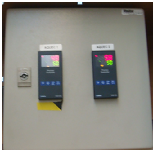
Figura 3.16: Painel de controlo externo.
