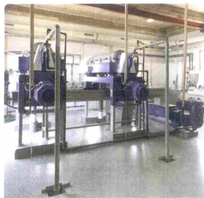
Figura 10: Zona de desidratação de lamas da ETAR de Febros (adaptado de [11])
