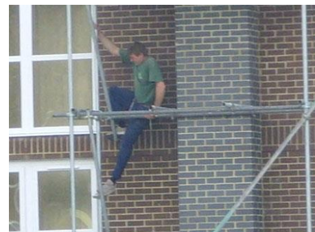
Figura 43: Andaimes sem proteção 2 .
