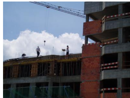
Figura 45: Exemplo de trabalhos em altura sem guarda-corpos 4 .
