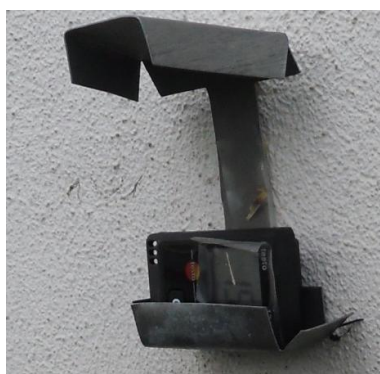
Figura 42 - Proteção em zinco dos sensores exteriores para as condições climatéricas adversas
