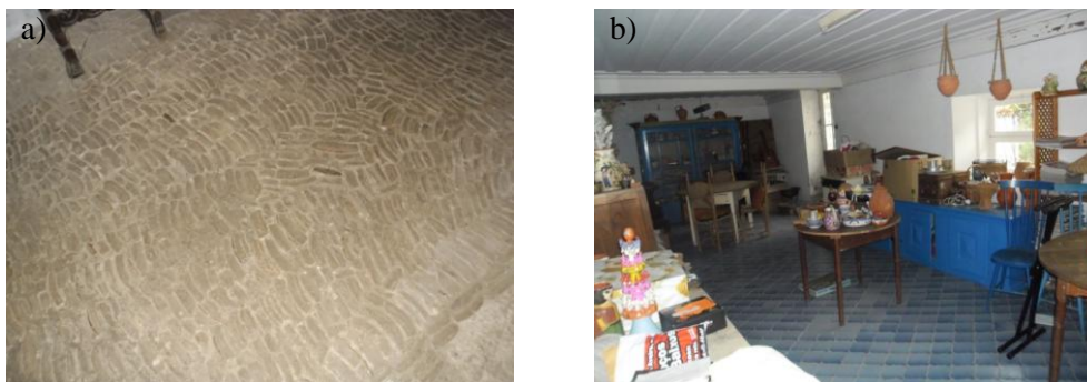
Figura 18 - Exemplos do revestimento do pavimento da cave: a) Revestimento em cacos de gazete; b) Revestimento em mosaico cerâmico
