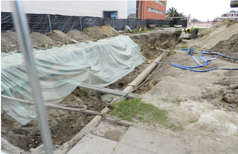
Figura 54 - Conduto original em fibrocimento, que liga uma estação elevatória à ETAR da cidade de Aveiro.
