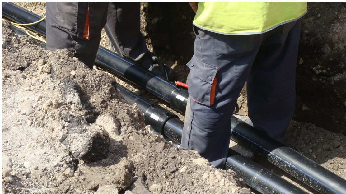
Figura 63 - Tubos em polietileno que ligam o permutador à bomba de calor.
