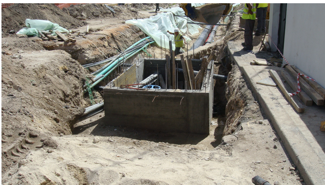
Figura 61 - Câmara de manobra e operação
