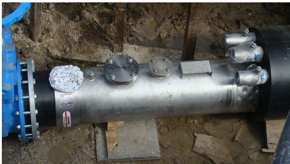
Figura 64 - Zona do permutador que se liga aos tubos de polietileno que conduzem o líquido à bomba de calor.
