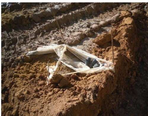
Figura 55. Captação a 150 m de profundidade
