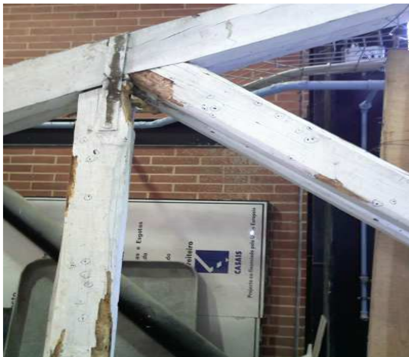
Figura 19 - Orifícios de saída provocados por insetos xilófagos no pendural 3.
