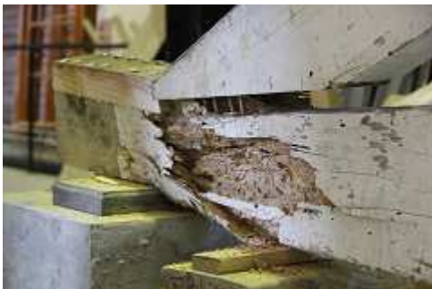
Figura 44 - Rotura da ligação Linha-Perna.
