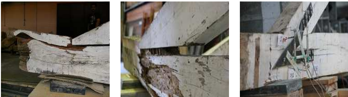
Figura 62 - Ruptura das asnas de madeira.
