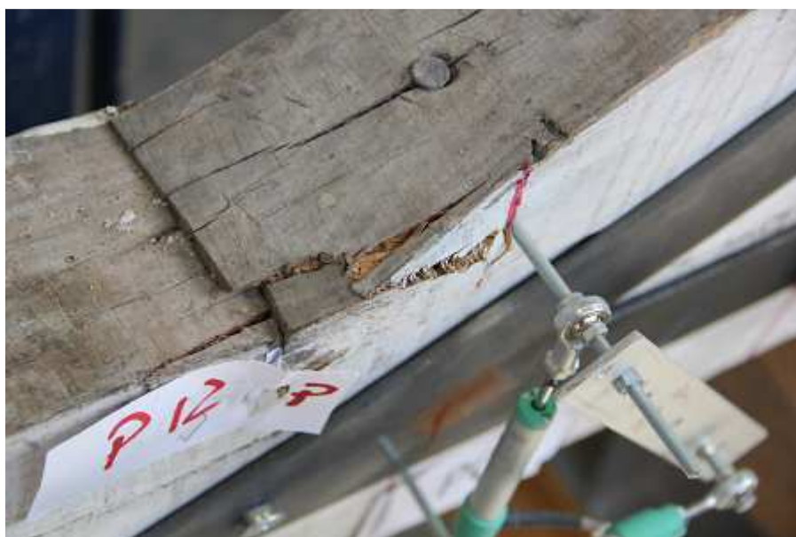
Arquivo fotográfico 8 - Esmagamento perna-linha.
