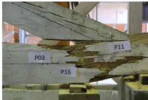
Figura 45 - Rotura da asna.
