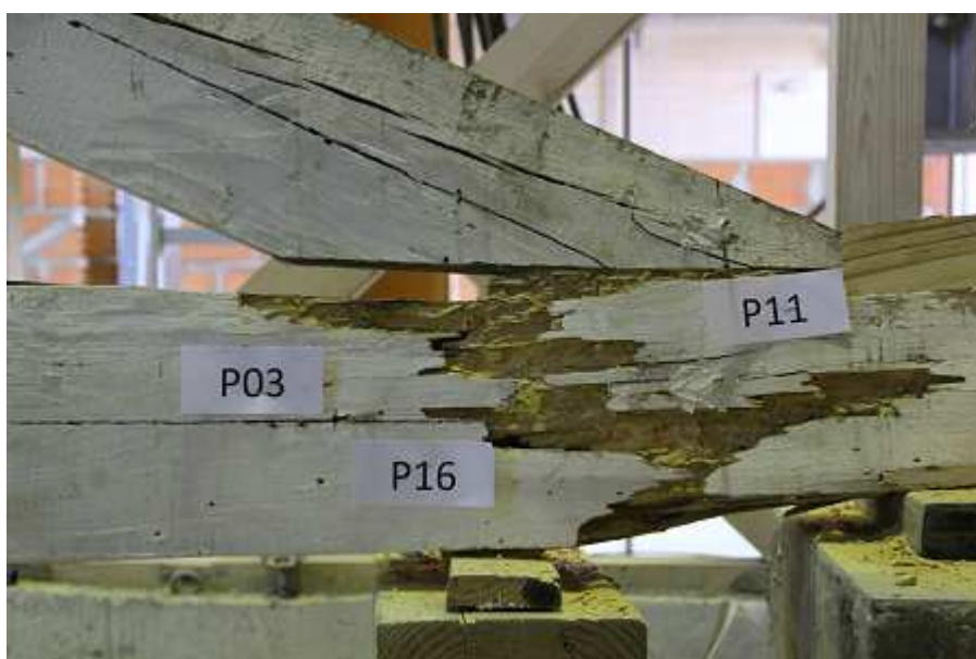
Arquivo fotográfico 6 - Rotura total, ligação linha-perna.
