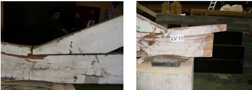
Figura 18 - Rotura devido ao esforço de corte.
