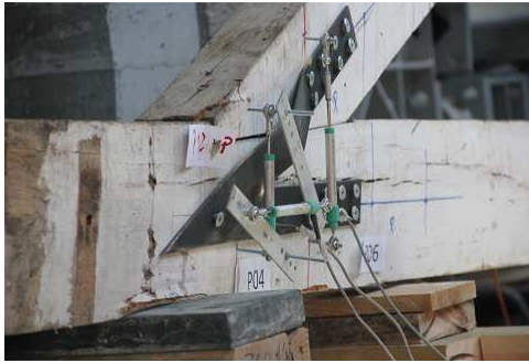
Figura 60 - Plastificação da chapa metálica na ligação Linha-Perna.
