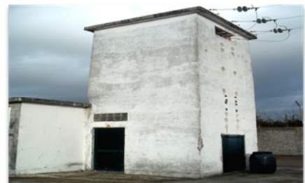
Imagem 7 - Posto de Transformação
