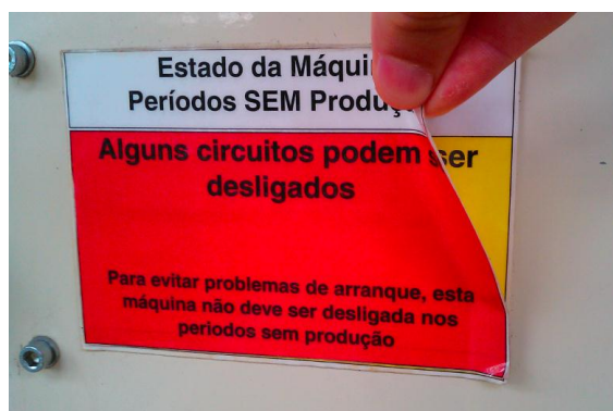
Figura 31 - Etiqueta indicativa do estado do equipamento em horário não produtivo.
