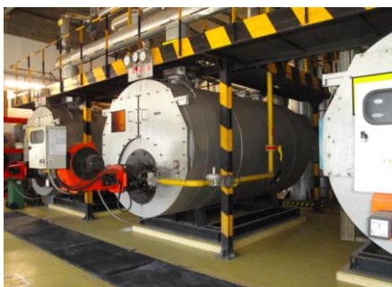
Figura 13 - Caldeiras de aquecimento de fluídos (Renault CACIA).
