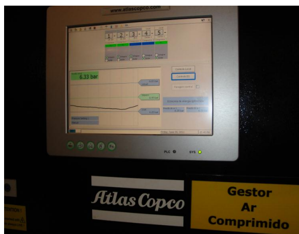
Figura 16 - Sistema de controlo de pressão do ar comprimido na rede.
