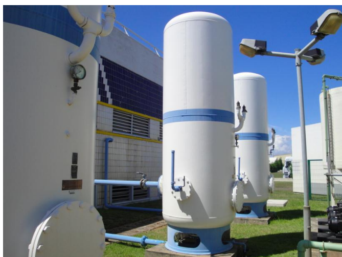
Figura 15 - Acumuladores de ar comprimido.
